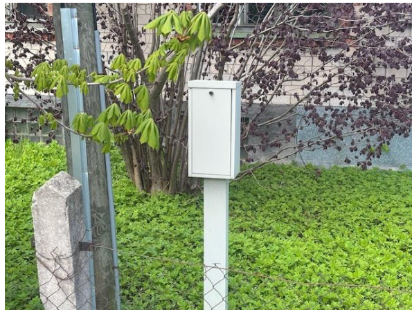
Elektrības sadalnes skapis
